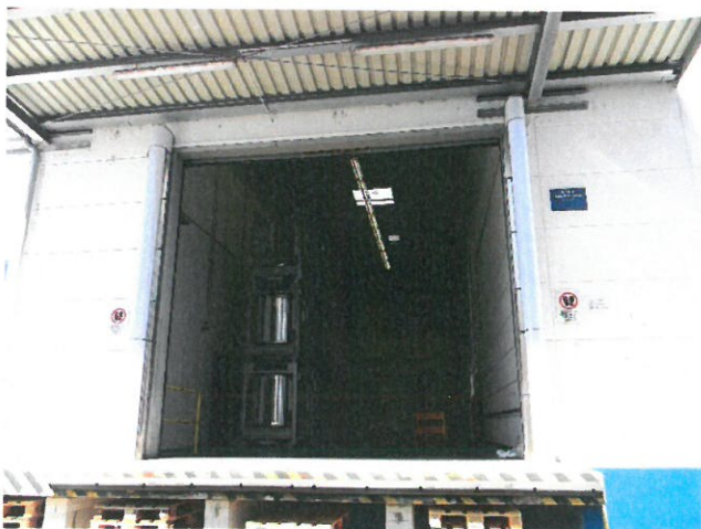
Die zwei ESM-Systeme am Logistikzentrum
