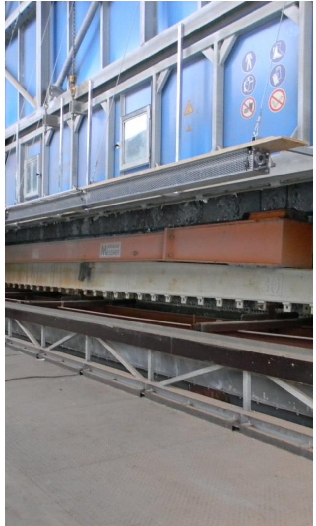
Verzinkungskessel mit ESM-System
