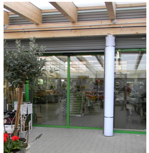
Klimatische Trennung zwischen Innen- und Außenbereich eines Gartenfachmarktes
